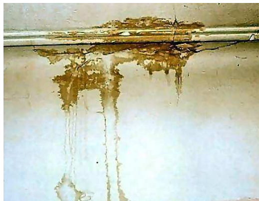
voorbeeld van lekkageschade
